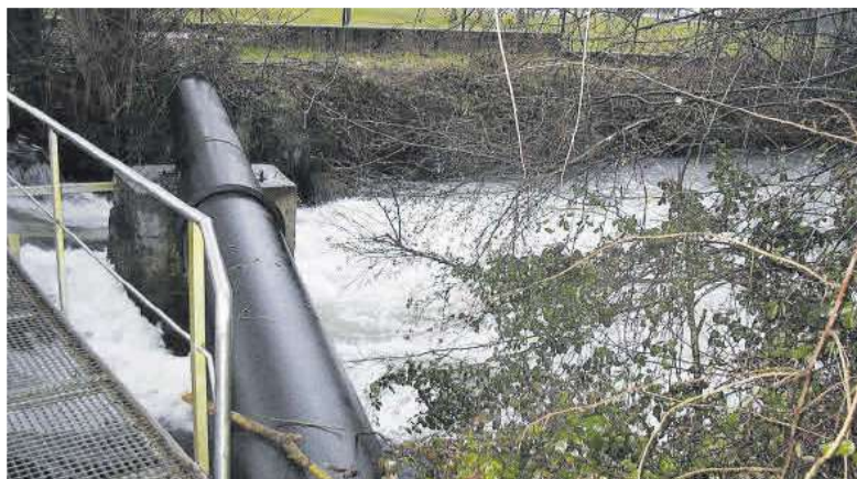
La tubería del Raigosu, en el entorno de la potabilizadora de Entralgo.
